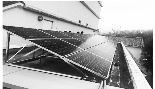
町文化センターの屋根置き太陽光パネル
