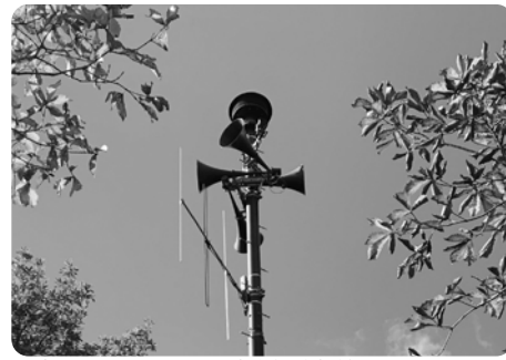
町内に設置されている防災行政無線
