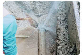
漏水のようす
