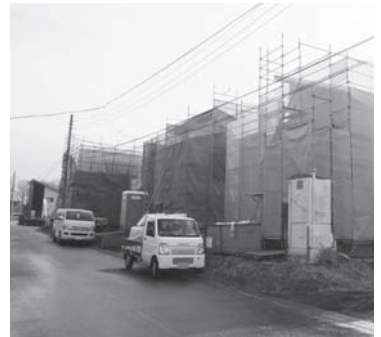
若者定住促進住宅3棟建設中（グリーンハイツ田中リビナス）
