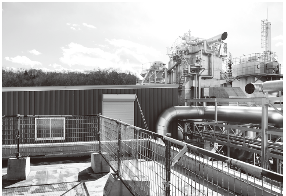
木質バイオマス発電所
