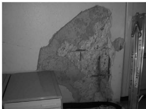
壁の一部が崩落
