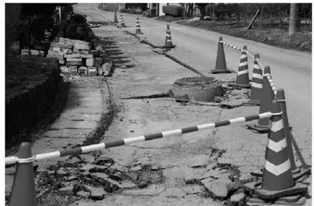
被災したマンホール（西大久保地内）
