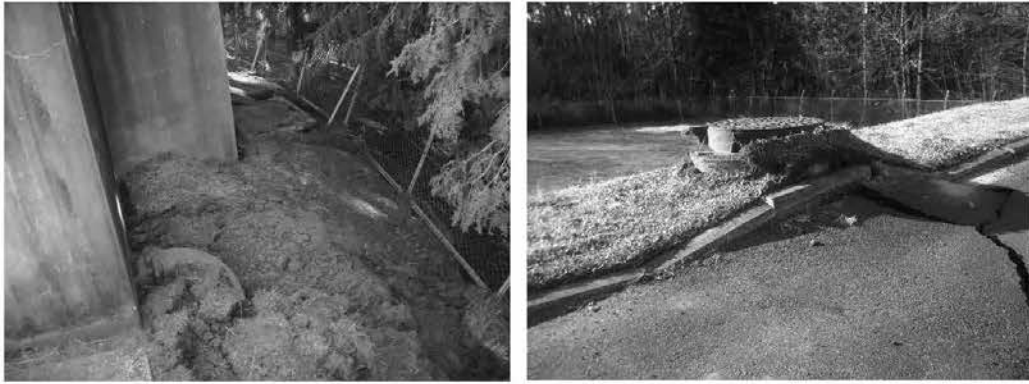
被害を受けた旧黒田浄水場
