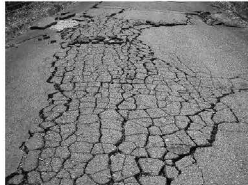
被害の大きかった相模13号支線
