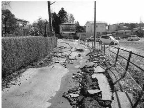
路面上に亀裂が生じた西大久保地内
