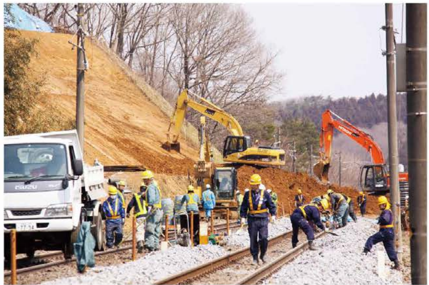
J R東北本線水原地内で、土砂が線路上に崩落した。懸命の復旧作業により4月17日に栃木県内の鉄道不通区間が解消された。
