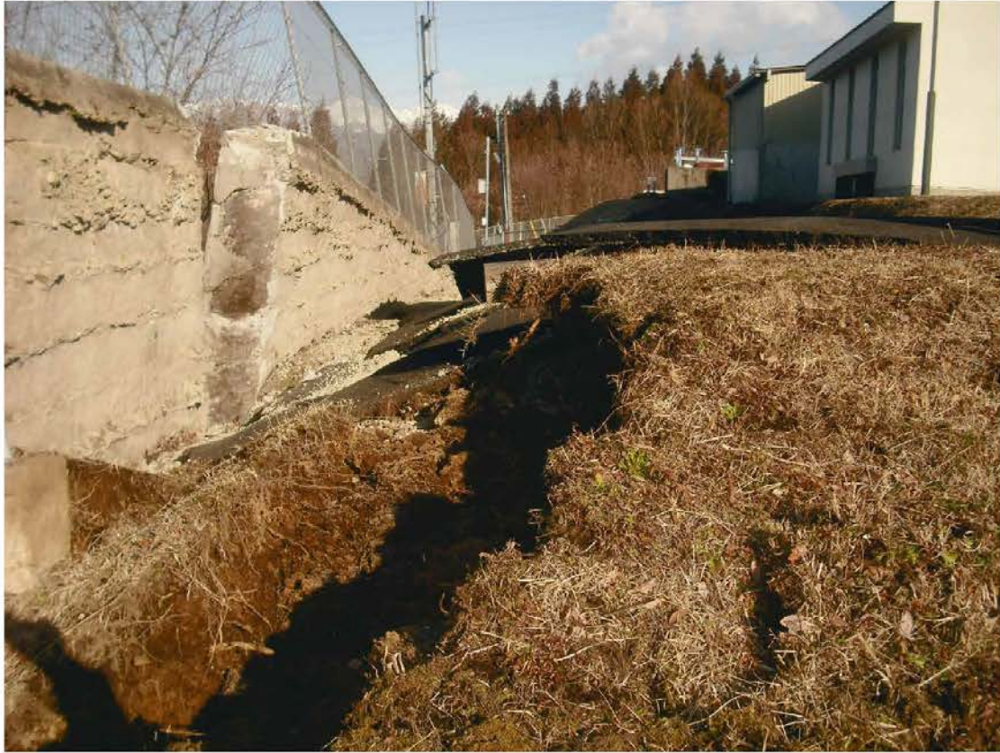
町内浄水場施設や配水管の破損など水道施設が大きな被害を受け、町内では一時 4,400 世帯が断水となった。
