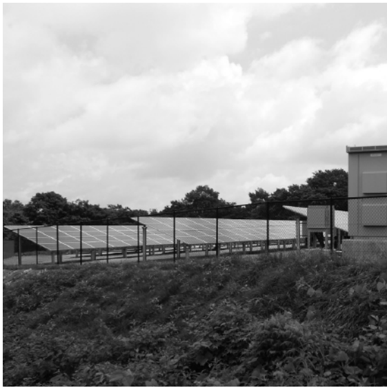
太陽光発電施設
