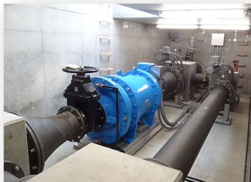
小水力発電設備の導入例
