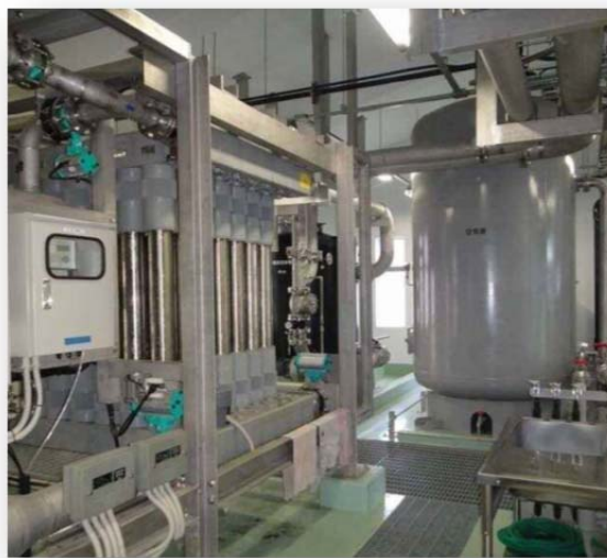
西山浄水場 膜ろ過設備
