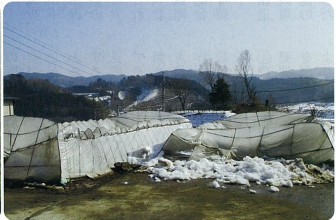
2月の豪雪による農業用施設の被害
